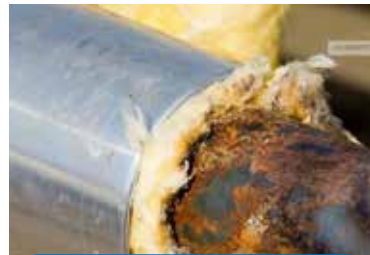
保温层下腐蚀
