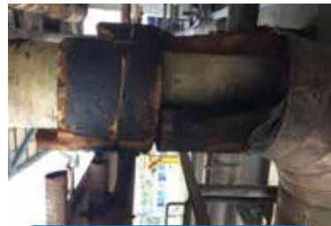
阻燃性能不足
