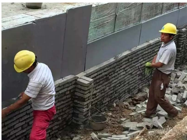
湿作业，辅材多，施工速度慢
