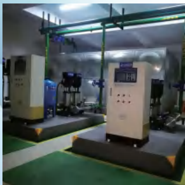
二次供水系统
