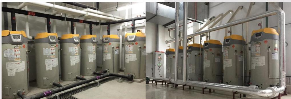
中国南方航空航空食品、运行保障中心、机务维修区淋浴&厨房热水，选用58台商用容积炉BTH、DRE/DSE系列
