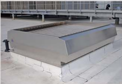
安装在工厂屋顶上的独立单元
