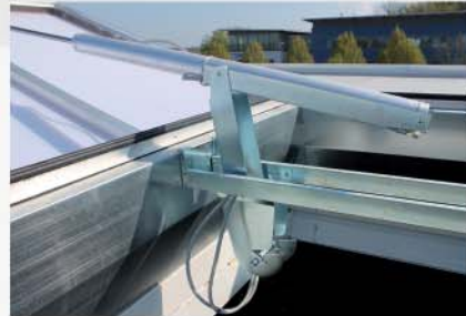
保障日常通风需要的电力驱动装置
