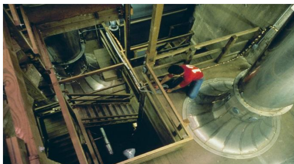
填料实验室进风口
